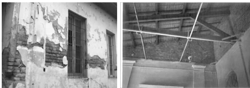
Figura 12.9 – Estado de muros por presencia de humedad (izquierda) y daño por sismo (derecha). Fuente: Gremientieri y Shmidt (2010), N. Maldonado, Martín, I. Maldonado y F. Calderón (2013).
